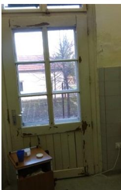
Slika 8: KP Vrapče, Odjel psihogerijatrije, derutna i stara zgrada
